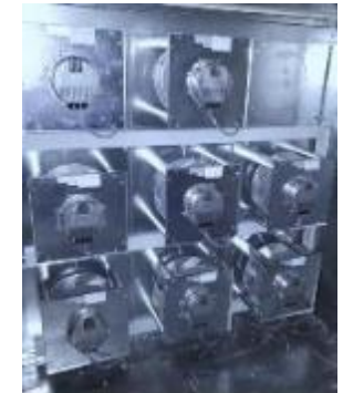
EC Fan Wall
